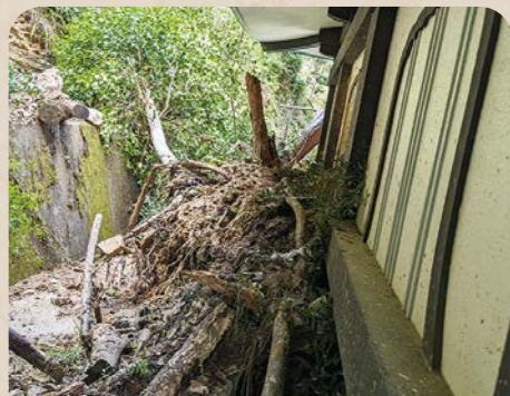
お堂裏に流れ込んだ土砂
