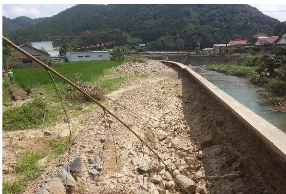
⑪ 堤防は無事だが、その内側が抉られた
